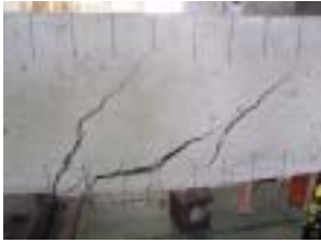
写真 - 7 最終破壊 状況 No.1
