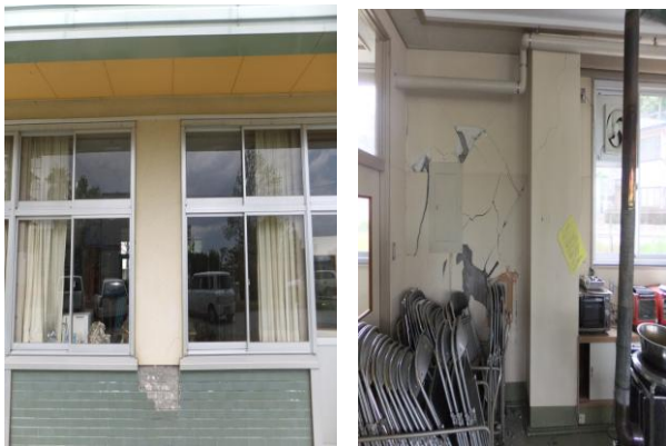
(a) 壁抜け柱(H19) (b) 袖壁付き柱(L20) 写真-1 1階の被害
