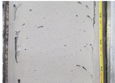
図-12 U リブ端部の未充填状況 (上り区間)
