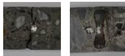
写真-2 コア鉄筋写真
