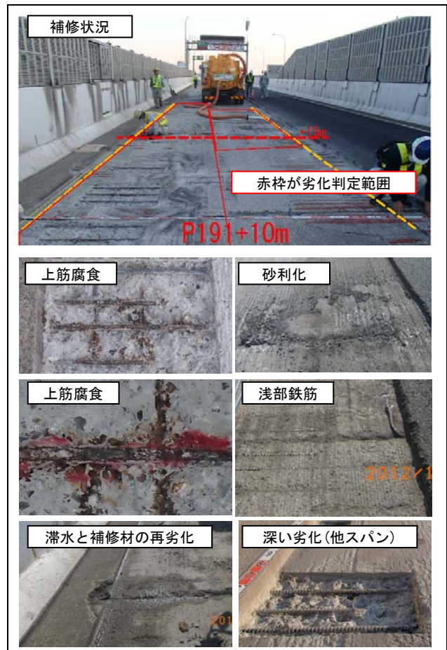
図-9 補修状況と劣化状況
