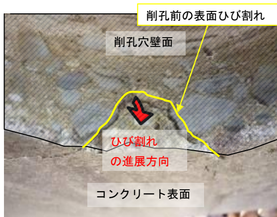
図-9 削孔穴からそれるひび割れの例
