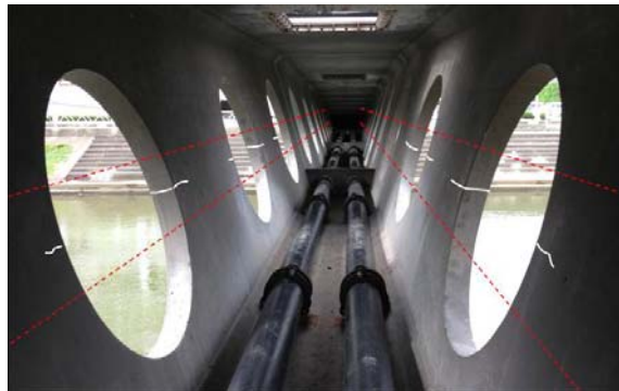
図-7 ウェブ開口部の両側に生じた橋軸方向のひび割れ
