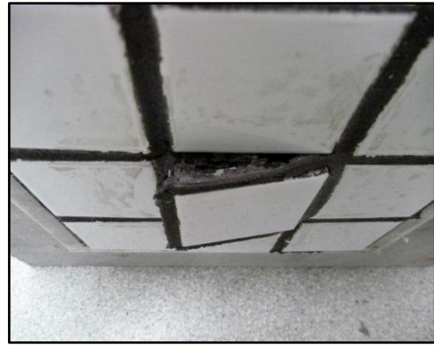
写真-2 押抜き試験後の状態 (目地モルタル+樹脂 50%)
