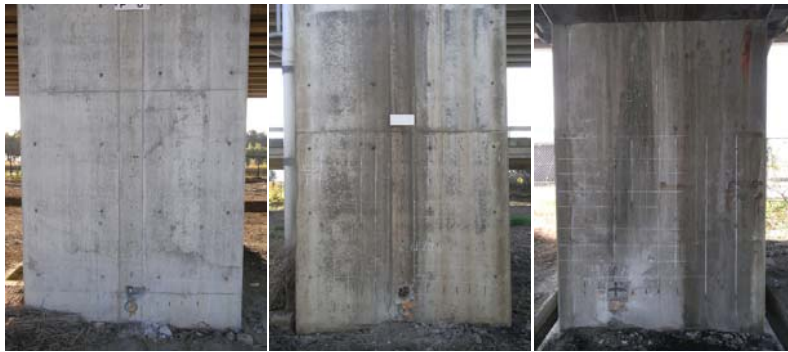
劣化：小（2 橋脚） 劣化：中（4 橋脚） 劣化：大（5 橋脚）
