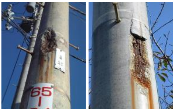
図-2 塩害環境における鋼材腐食事例
