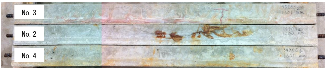
写真-3 試験体側面の腐食ひび割れ性状
