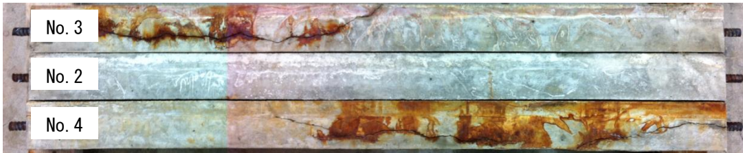
写真-2 試験体側面の腐食ひび割れ性状
