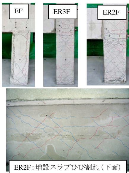
図-6 最終ひび割れ状況
