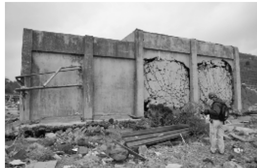
写真-1 RC 造外壁の被害状況の一例
