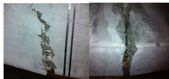
写真-3 载荷後のひび割れ断面(左 : FMH2 右 : FMV)
