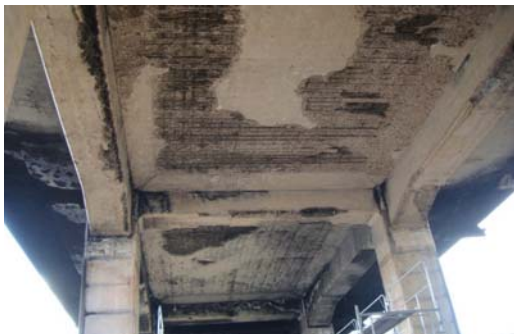
写真-1 火災による被災を受けた鉄道高架橋
