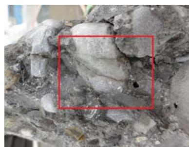
写真-6 骨材に発生したひび割れ
