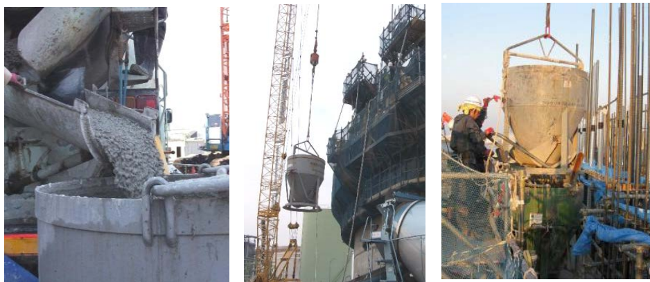
写真-3 コンクリートの荷卸しおよび揚重バケットによる運搬状況
