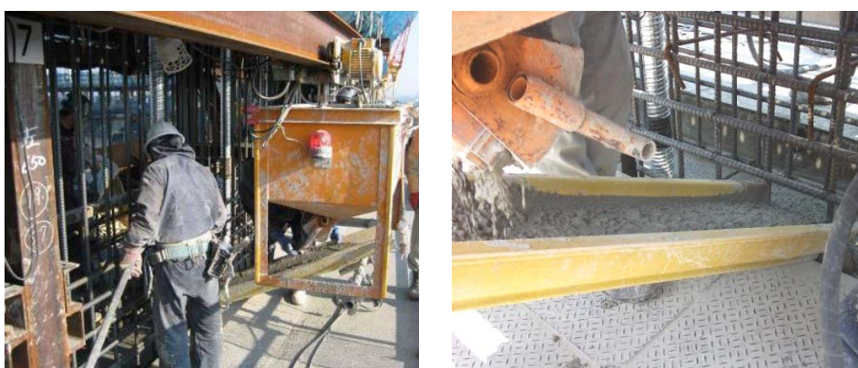
写真-4 搬送用バケットによる運搬およびシュートによる打込み状況
