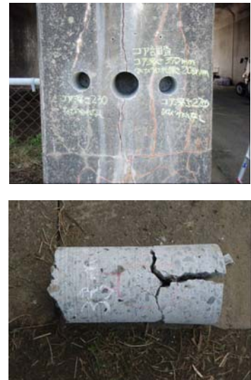
図-3 コア採取位置とコアのひび割れ状況
