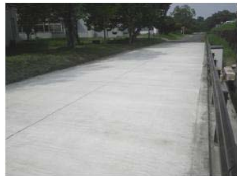
写真-2 舗装版体の状況
