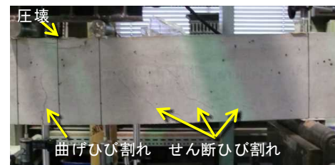
写真-2 No. 2 (せん断補強筋) 曲げ破壊状況
