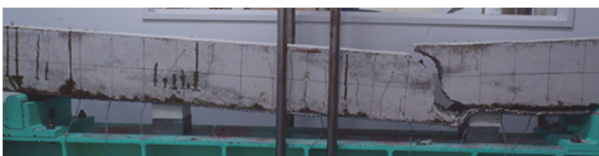
写真-2 BFRP シート剥離の様子 (BF-H)
