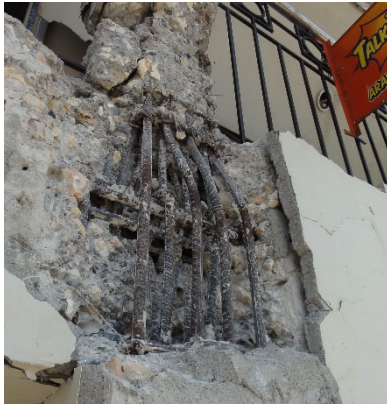
写真-2 接合部 (図2のX12-Y1の2階)の被害
