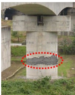
図-1 RC 橋脚く体中間部での損傷事例
