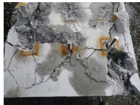
図-14 試験後の母材コンクリート(8-1~3)
