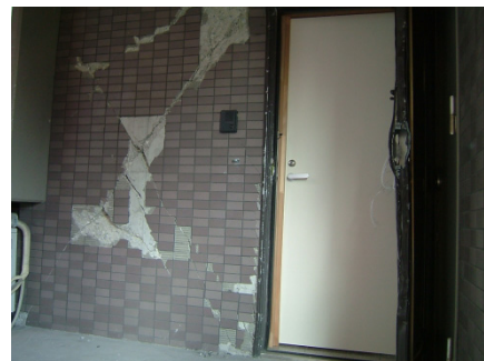
写真-1 二次壁の地震被害 1)
