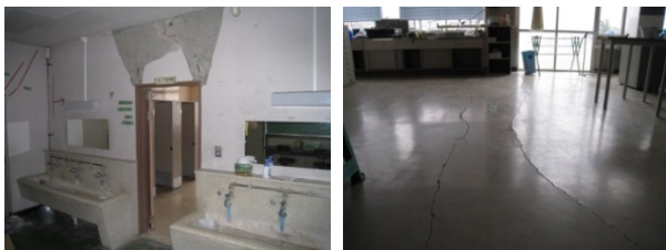
(c) 仕上げ材の剥落 (d) 1階床スラブのきれつ 写真-2 代表的な被害の様子
