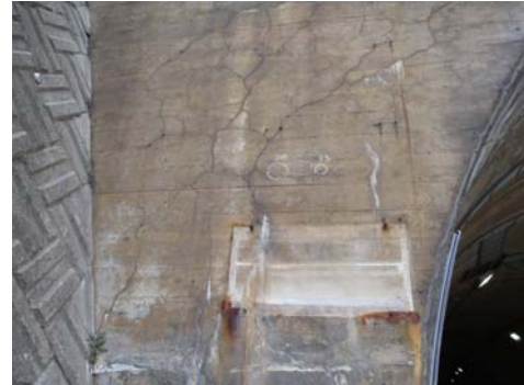
写真-6 終点側トンネル坑口の ASR 劣化状況
