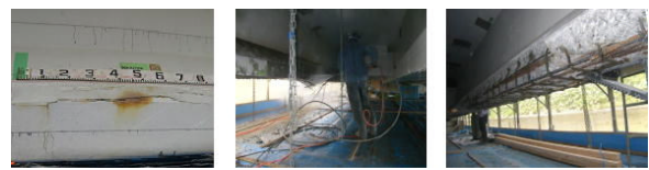
(1) 水平ひび割れ (2) 脆弱部除去 (3) 鉄筋の破断
