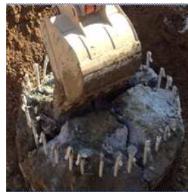
写真 - 17 亀裂拡大 (杭 No.24)
