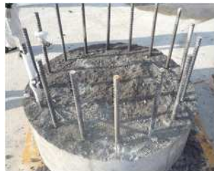
写真 - 24 破断面状態
