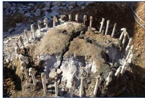
写真 - 16 破砕状態:上面(杭 No.24)
