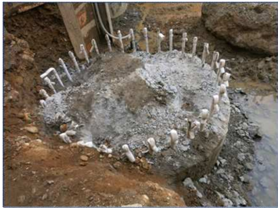
写真 - 8 掘削工事後の杭頭の状況
