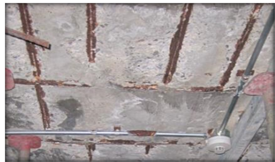
写真-1 劣化した構造物
