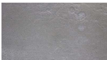
写真-7 材齢28日表面状況
