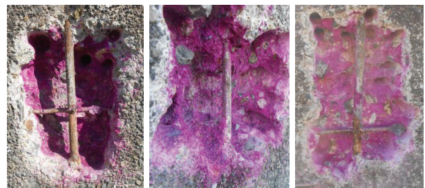
写真-3 内部鋼材の腐食と中性化の状況
