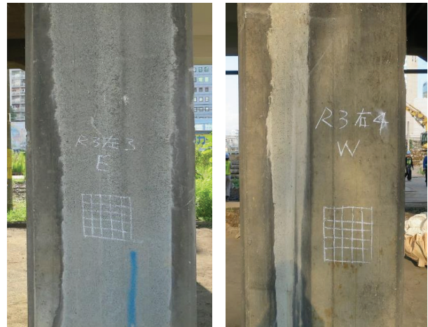
(左) 雨垂れ箇所 (右) 通常箇所 写真-4 リバウンドハンマー試験箇所の状況
