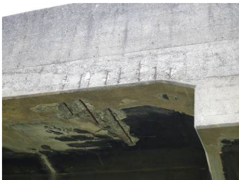
写真-2 場所打ち高欄および張出しスラブ下面の変状
