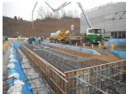
写真-1 大型構造物載荷試験装置の基礎コンクリートの打ち込み状況
