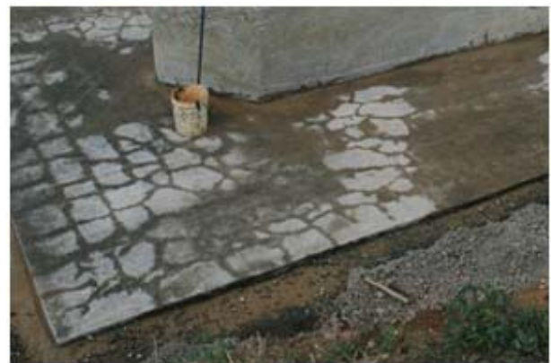
図 - 1 スリランカの橋脚フーチングの亀甲状ひび割れ
