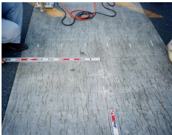
写真-5 PC 舗装(事例Ⅲ)の劣化状況
