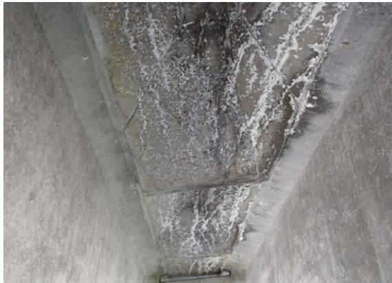
写真-3 PC 橋梁・PC 床版（事例Ⅱ）の劣化状況
