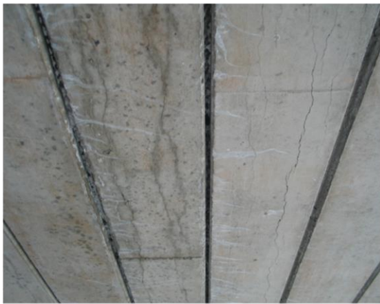
写真-1 プレテンション式PCホロー桁（事例I）の劣化状況
