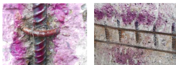
(a)健全部 (b)腐食部
