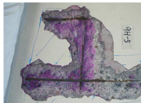
写真-1 バルコニースラブ下端筋の腐食状況
