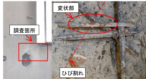
写真-2 開口隅角部における変状部の鉄筋の腐食状況
