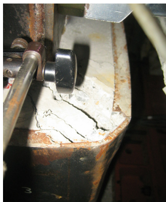
写真-2 接合鋼管の面外座屈状況 (試験体 B3)
