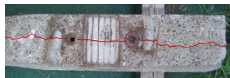
(a) まくらぎ上面の縦ひび割れ
