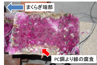
図-15 ショルダー部の破壊面の状況
