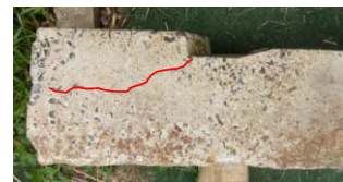
(b) まくらぎ側面の縦ひび割れ
