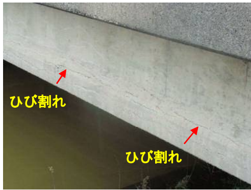
写真-3 プレテン桁の ASR によるひび割れ
