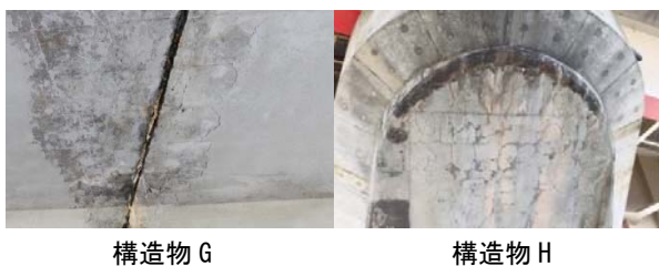
写真-4 ケイ酸ナトリウム系表面含浸材塗布後の損傷状況 (2015 年の状況)
