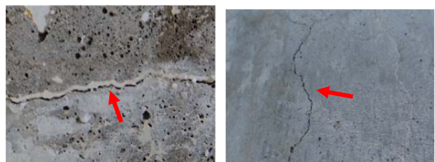
写真-5 ひび割れ注入材の損傷状況 (構造物 L) 写真-6 新しいひび割れの発生 (構造物 I)
