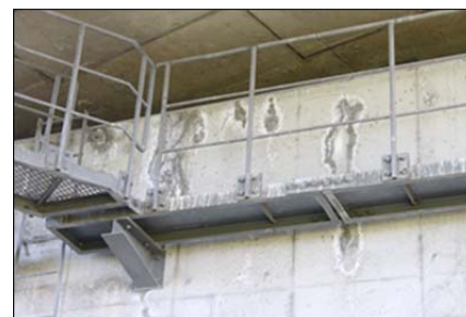
写真-8 遊離消石灰の滲出し (構造物 P)
