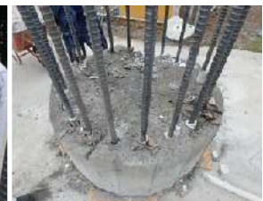
写真 - 22 破断面の状態 (試験体 3)
