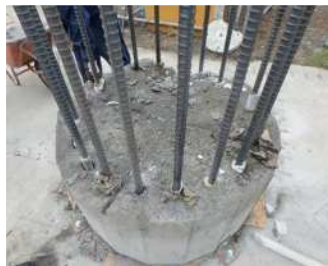
写真 - 16 破断面の状態 (試験体 2)
