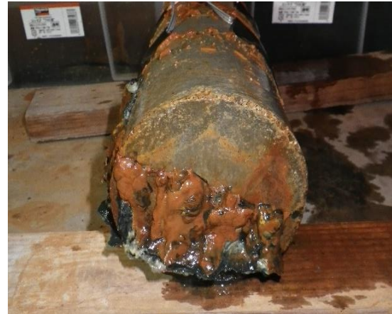
図-4 腐食生成物の流出（腐食減量率:約35%）
