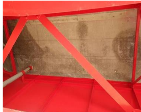
写真-2 床版下面 パネル 2-1 漏水状況
