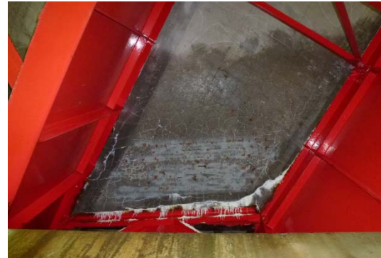
(b) ジョイント近傍のRC床版裏面
