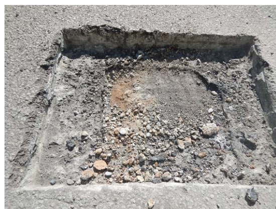
図-1 道路橋床版における砂利化
