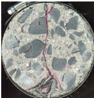
図-5 内部ひび割れの様子
