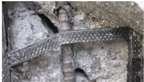
写真-4 CFG板横筋のせん断変形 (C8C3 後面)
