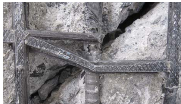
写真-6 CFG板横筋の一部破断 (C8C3 前面)
