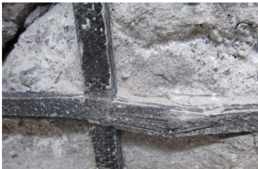
写真-3 CFG板横筋のせん断変形 (C8C2 前面)
