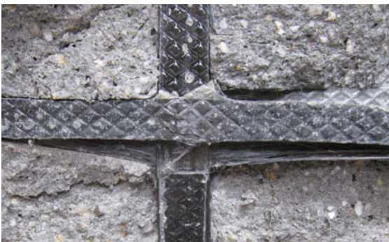
写真-5 CFG板横筋の繊維方向の割れ裂け (C8C2 前面)
