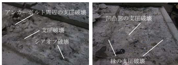
写真-2 载荷後の PCM 接合面の破壊状況
