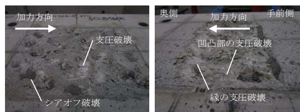
写真-1 PCM 接合面の破壊状況
