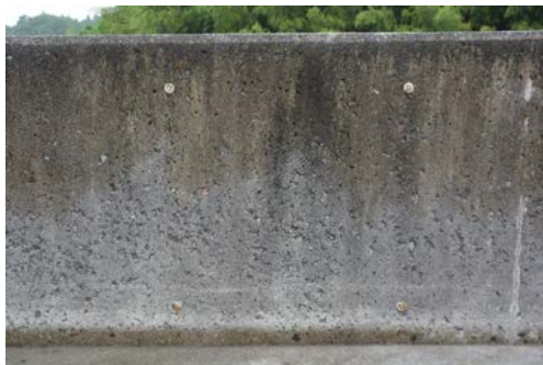
実際の壁高欄の劣化状況
