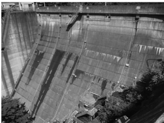
図-1 水平打継目が剥離したダム堤体の事例
