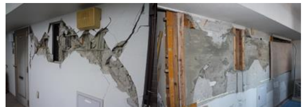
(a)被災時(せん断破壊) (b)復旧工事中
